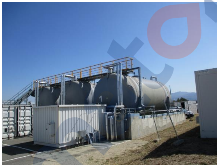
Figure HH : Cuves tampons en sortie de la station de traitement NEPTUNE
